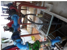
Pumpna / filterska stanica industrijskog vodovoda
