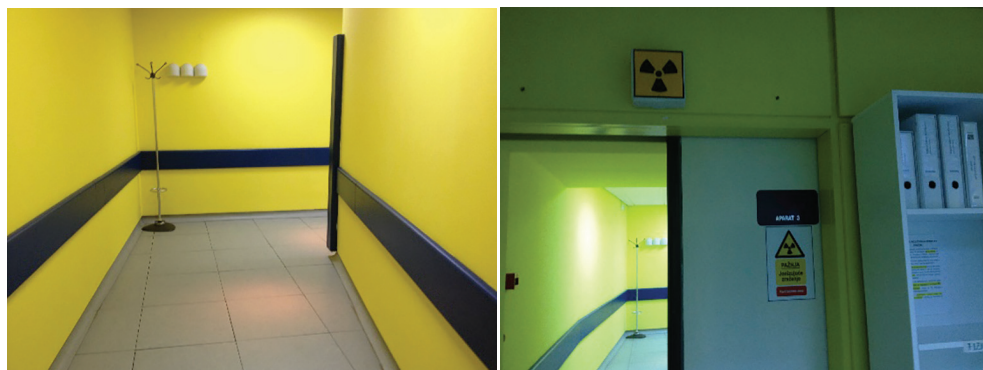
Slika 1. Ulaz u bunker, labirint i zaštitna vrata
